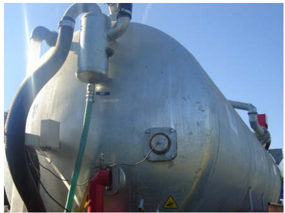
Figura 1. Conductímetre instal·lat a la cisterna (DACC, 2016)
