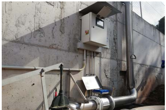
Figura 2. Conductímetre instal·lat a la instal·lació d'emmagatzematge (DACC, 2021)
